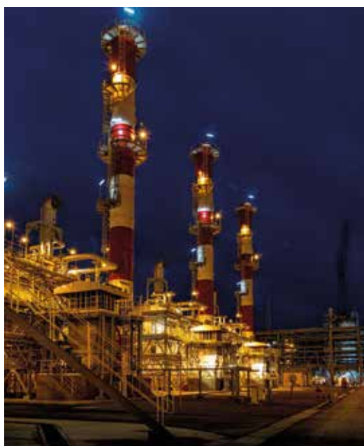
VEDUTA NOTTURNA DELL'IMPIANTO
