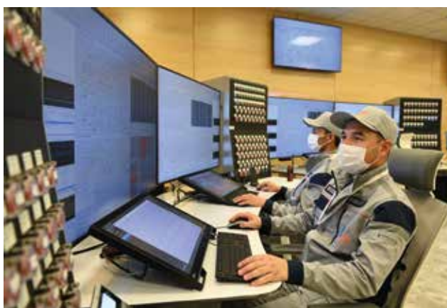
DATA CENTER PER LA GESTIONE E IL MONITORAGGIO DEGLI IMPIANTI A DISTANZA
